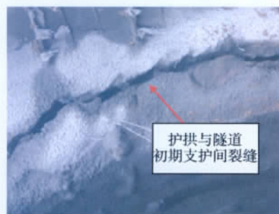
图5 初期支护与护拱间的脱离裂缝
