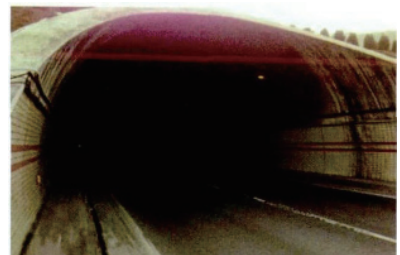
图11 隧道洞口照明条件不良
