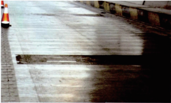
图9 刻槽构造过度磨损
