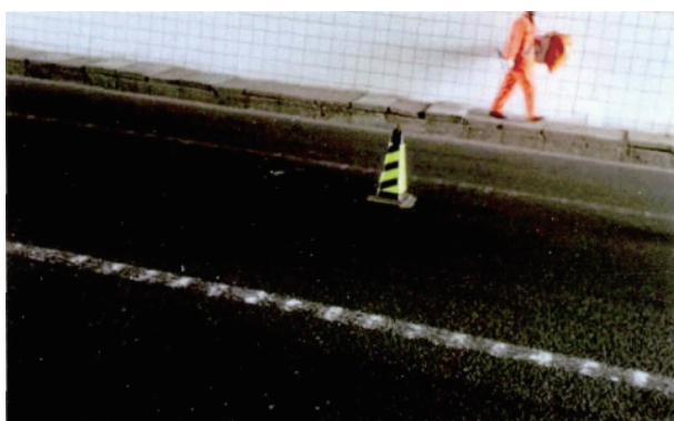
图4 道路标线失效
