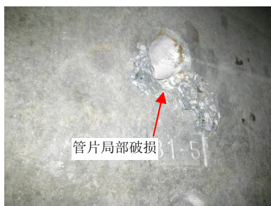
图 12 管片局部破损
