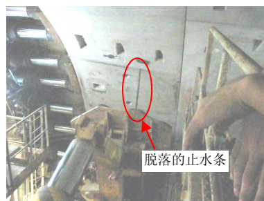
图 13 拼装封顶快时止水条脱落
