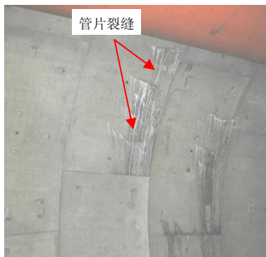
图6 施工期管片裂缝
